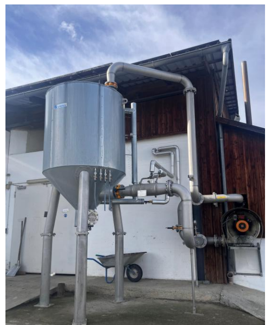
Aktivkohlefilter zur Entschwefelung des Biogases
