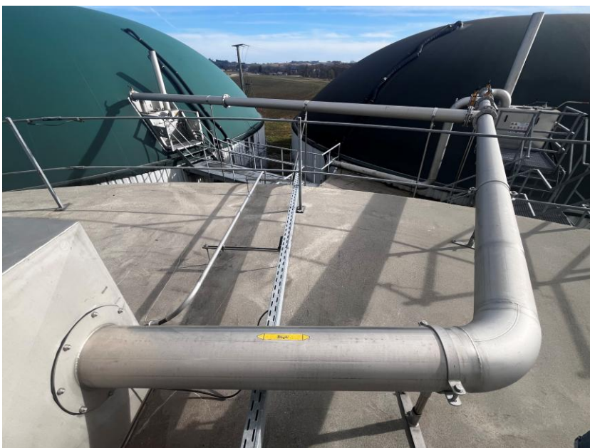
Biogasleitung in der Biogasanlage Anschütz
